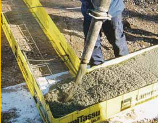
Mahdollisten lisäraudoituksen asennuksen jälkeen valmismuotti valetaan betonilla ja yläpinta tasataan oikeaan korkoon.
